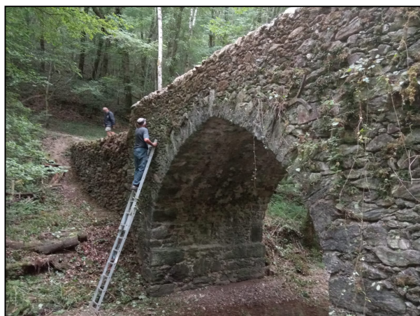
Photo prise au cours du nettoyage du vieux pont par les bénévoles.
